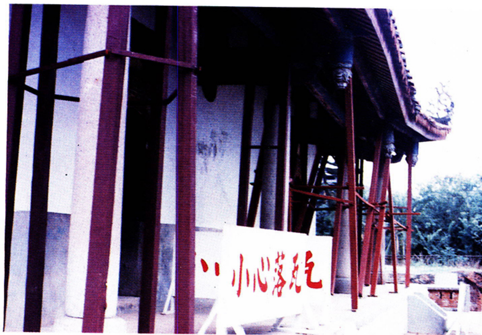
圖 4 目前文昌閣背面景觀，屋頂已然塌陷，亟待維修
