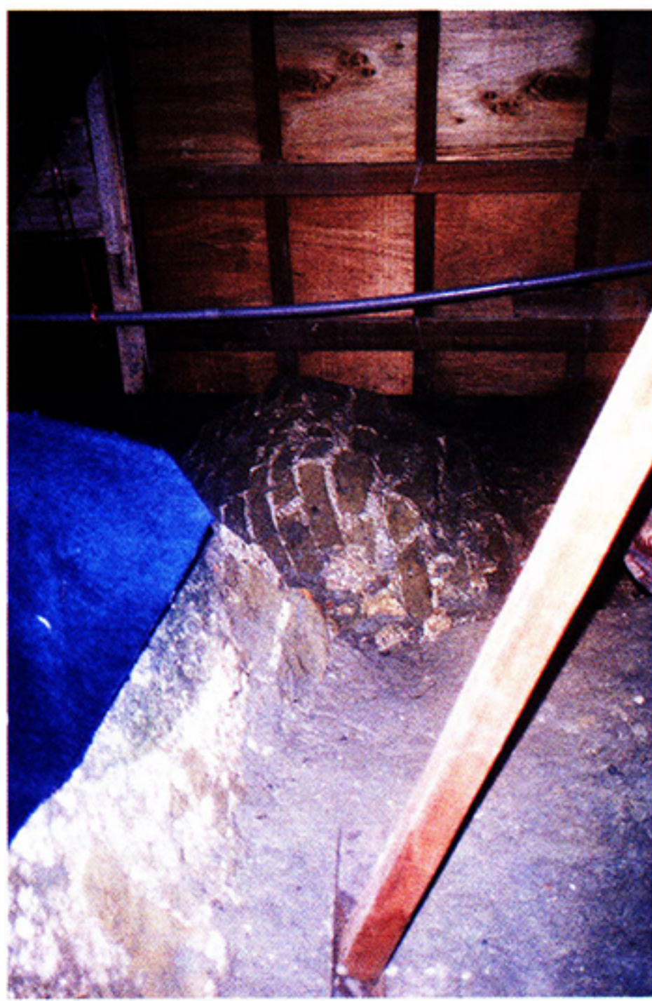
圖一八 第二道土牆中間處斷落錯開
