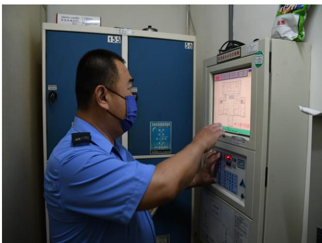
(2-1) 值班保全檢查判別受信總機警示位置
